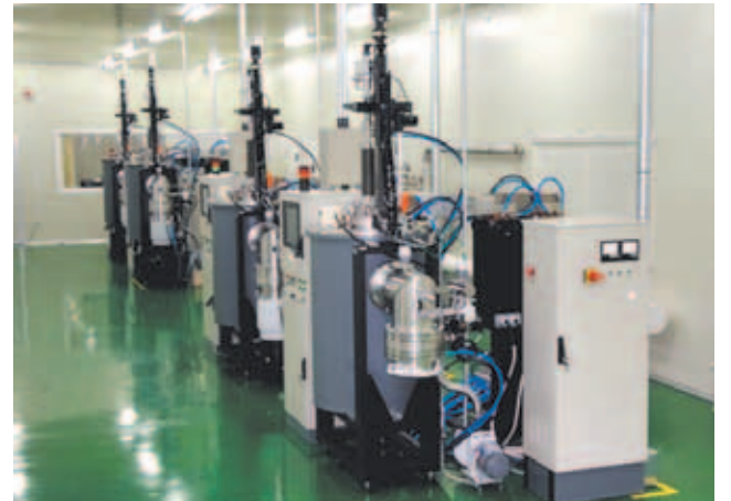
Зал с установками НИКА-М60 на ЭЗАНе
